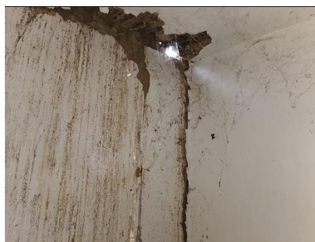
A fal repedése.
